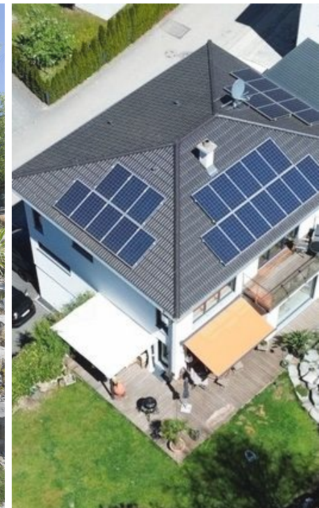
7,14 kWp PV-Anlage (28 Module)
